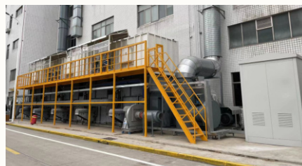
喷涂废气处理设施
